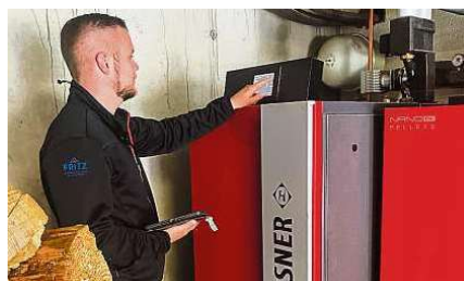
Die Heizungs wartung steht vielerorts ins Haus. Dieser Service wird ausschließlich vom SHK-Handwerk geleistet. Foto: Fritz
